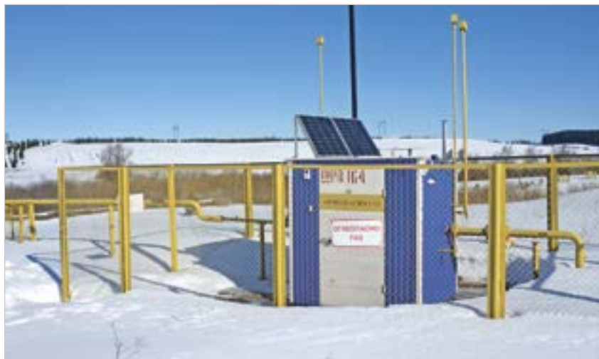
Рис. 5. ГРПБ с солнечным электрогенератором
