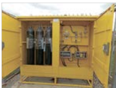
Рис. 3. Система АСДУК в шкафом исполнении
