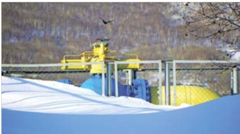
Рис. 4. Шаровый кран на газопроводе ДФО
