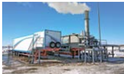
Мобильная парогенераторная установка «ЗиО» на месторождении нефти в Самарской обл.
