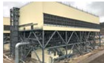
Сухая вентиляторная градирня, выполненная «под ключ» Группой «ЗиО»
