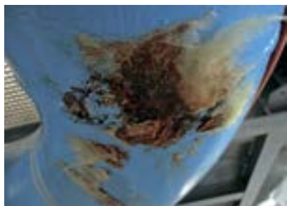
Рис 1. Коррозия, образующаяся на внешней поверхности трубопроводов, сосудов под давлением и конструктивных опор
