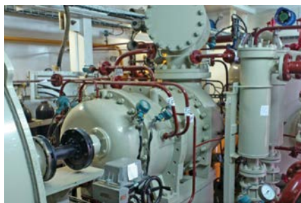
Рис. 2. Компрессор ВГ-50/16 БМ УХЛ1 в составе установки утилизации попутного нефтяного газа
