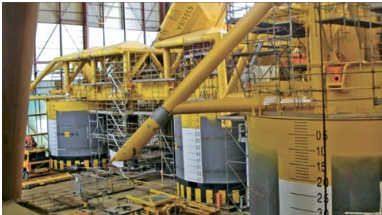
Рис. 3. Оборудование ПДК, установленное на сваях-оболочках кессонного типа Fig. 3. Subsea production complex equipment installed on suction piles
