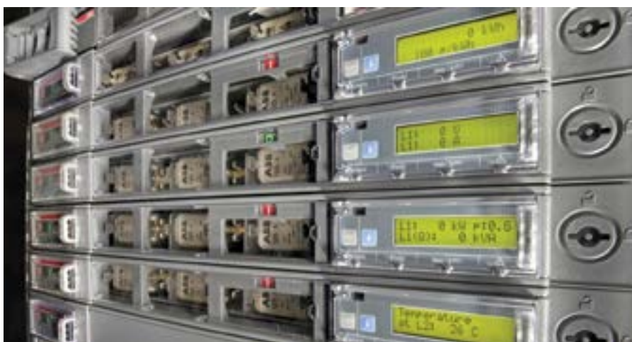
Аппараты SlimLine XR ITS MOT, установленные на систему шин
