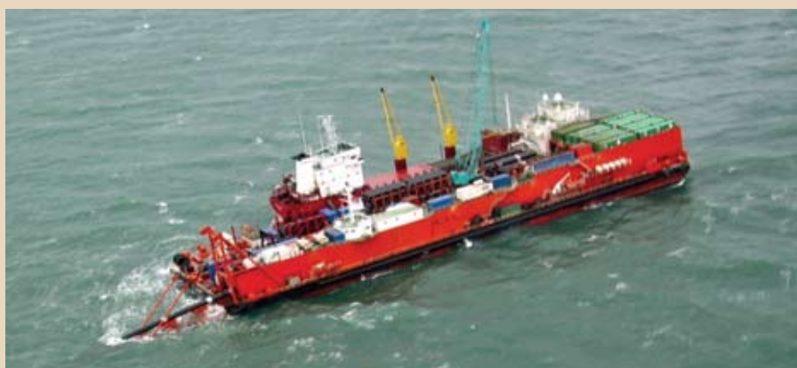
Рис. 4. Строительство подводного перехода через Байдацкую губу СМГ «Бованенково – Ухта» с применением трубоукладочной баржи
