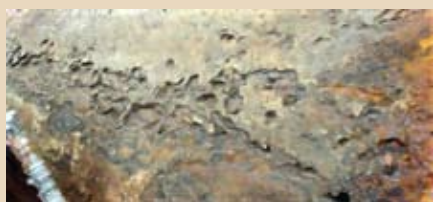
Рис. 1. Коррозионные дефекты на внешней КЗП трубопровода после 32 лет эксплуатации
