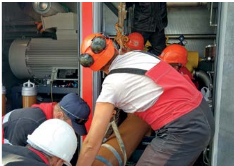
Фото 4. Пусковая установка для ГТЭС Восточно-Перевального месторождения. Закладка элементов маслосистемы после промывки и модернизации
