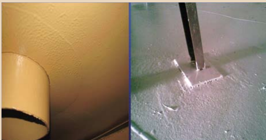
Рис. 4. Непровары сварных швов
