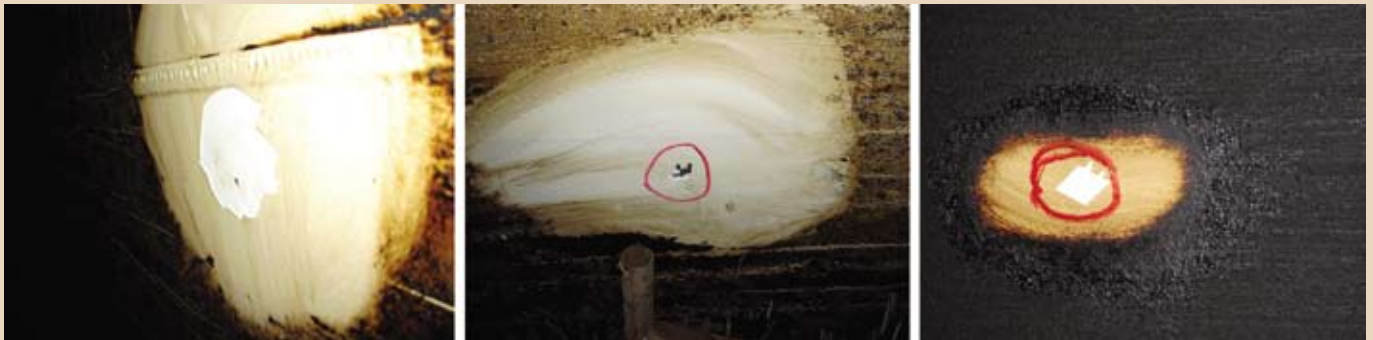
Рис. 8. Неудовлетворительная межслойная адгезия в результате нарушения технологических режимов при нанесении ЛКМ
