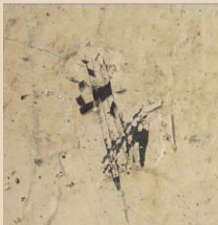
Рис. 3. Некачественная подготовка поверхности (загрязнения под покрытием)
