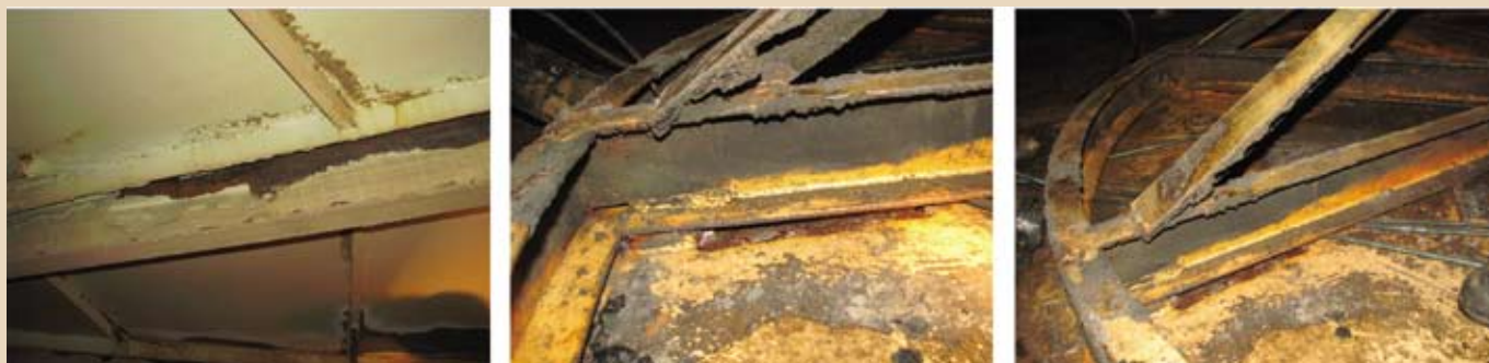
Рис. 5. Последствия непроваров сварных швов
