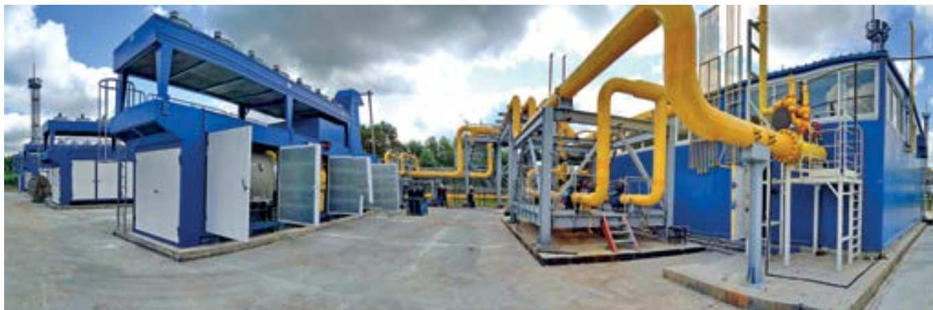
Фото 9. Система комплексной газоподготовки и газоснабжения «ЭНЕРГАЗ»
