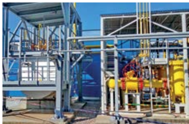
Фото 4. Входной блок фильтрации и узел дренажа конденсата ППГ
