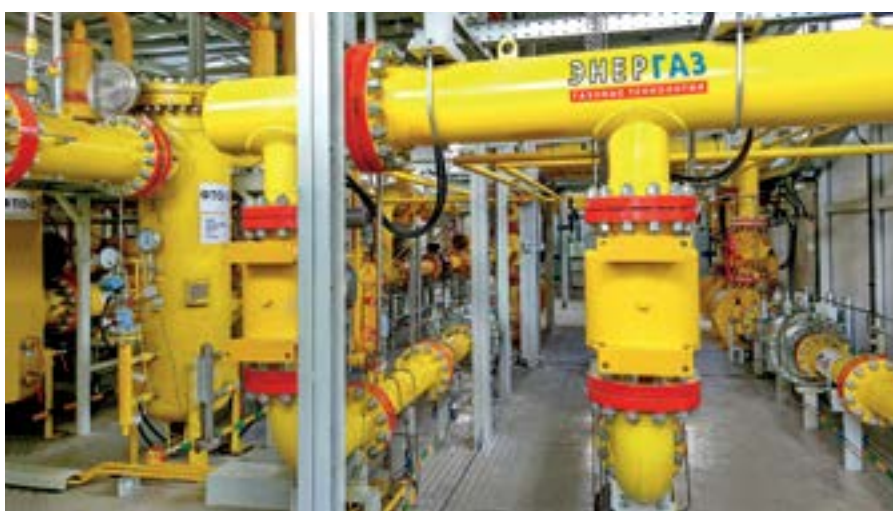
Фото 5. Технологические отсеки пункта подготовки газа «ЭНЕРГАЗ»
