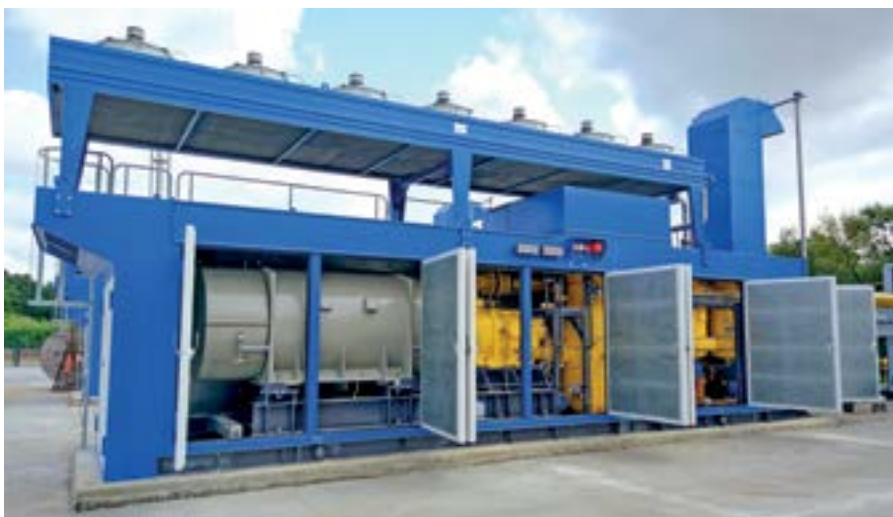
Фото 7. Компpressorная установка № 1 в составе ДКС топливного газа
