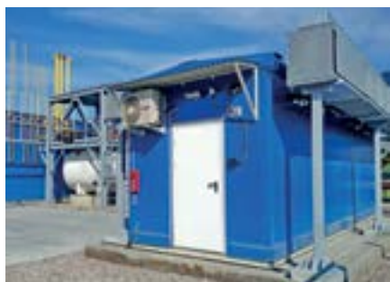
Фото 8. Модуль управления локальными САУ
