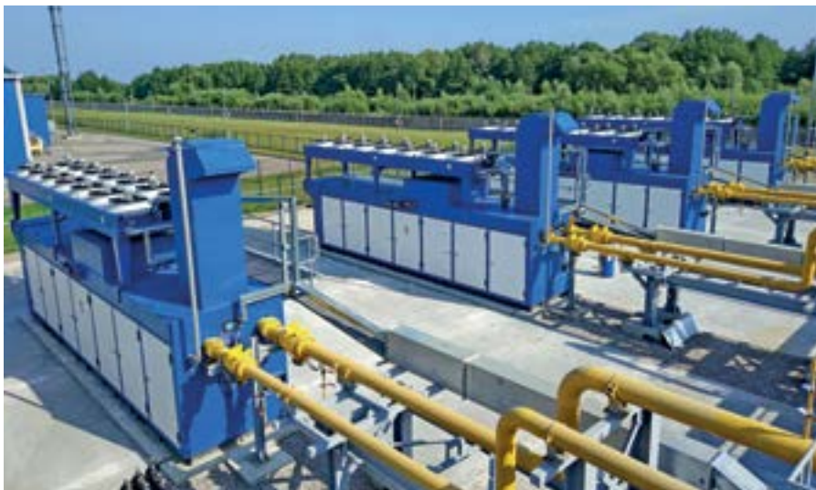
Фото 6. Дожимная газокomppressorная станция
