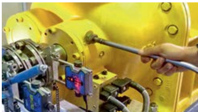
Фото 3. Настройка компрессорного оборудования КС № 4 «Западный Тэбук» после модернизации
