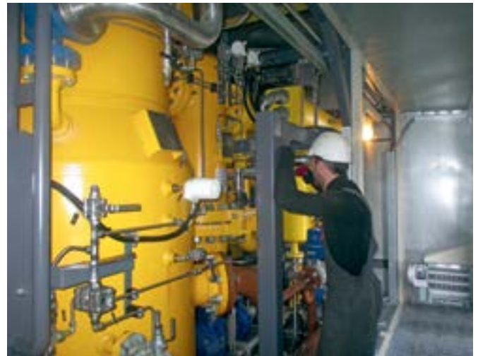
Фото 8. Подразделение «СервисЭНЕРГАЗ-Ухта» обеспечивает бесперебойную эксплуатацию систем газоподготовки на энергоцентрах ООО «ЛУКОЙЛ-Коми»
