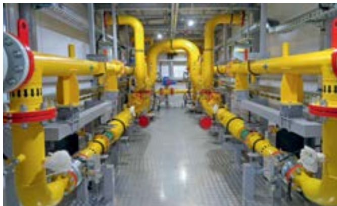
Фото 3. Газорегуляторный пункт обеспечит топливом печи прямого нагрева нефти на установке подготовки нефти «Уса – Тяжелая нефть»
