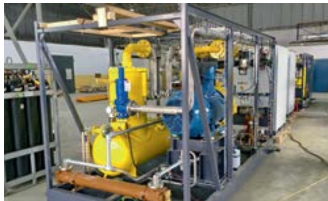
Фото 4. Установка рекуперации отпарного газа для комплекса по сжижению природного газа «Тобольск» на этапе заводских испытаний
