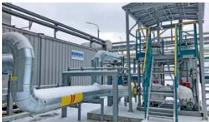
Фото 1. Высокоэффективная система фильтрации отходящего газа
