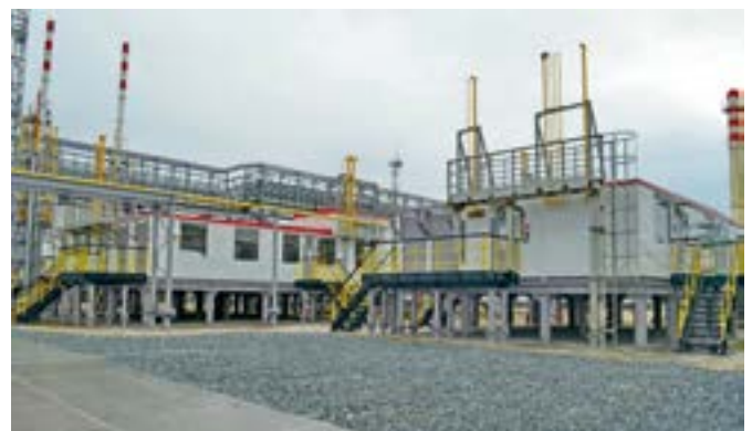
Фото 2. Установка подготовки топливного газа для объектов установки комплексной подготовки газа и конденсата на Восточном Уренгое
