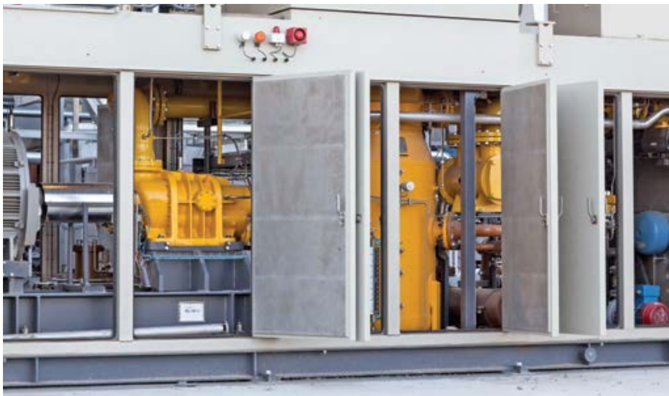
Фото 7. ДКС обеспечивает турбины газом с проектными параметрами по чистоте, давлению и температуре
