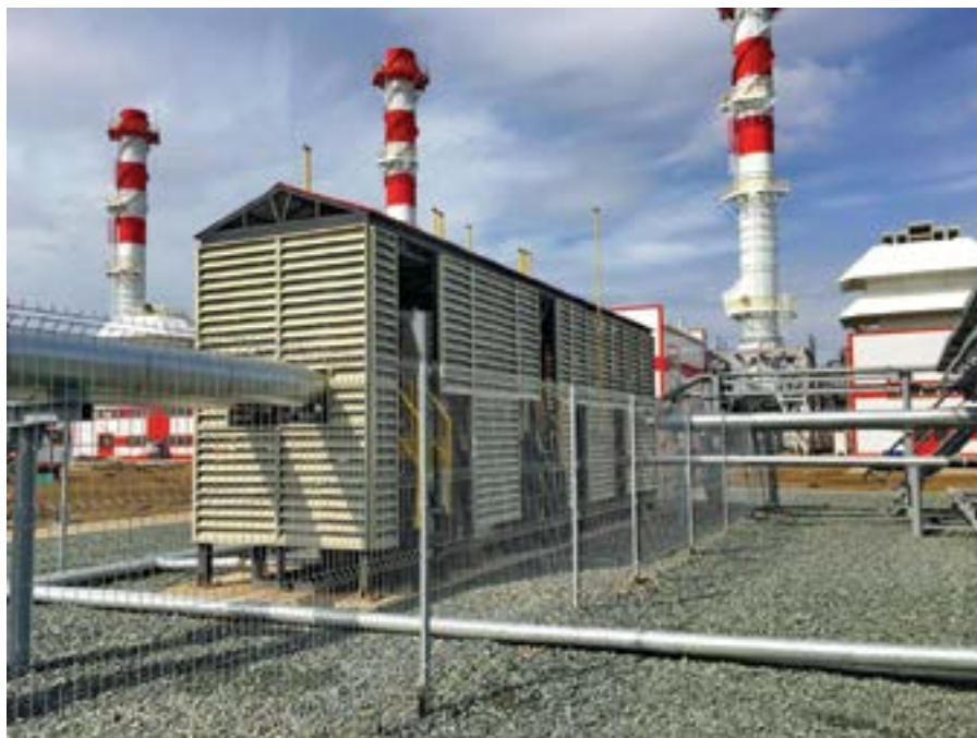
Фото 1. БПТГ «ЭНЕРГАЗ» для энергоцентра собственных нужд ООО «ЛУКОЙЛ-Коми» (ГТУ-ТЭЦ, Усинское месторождение)
