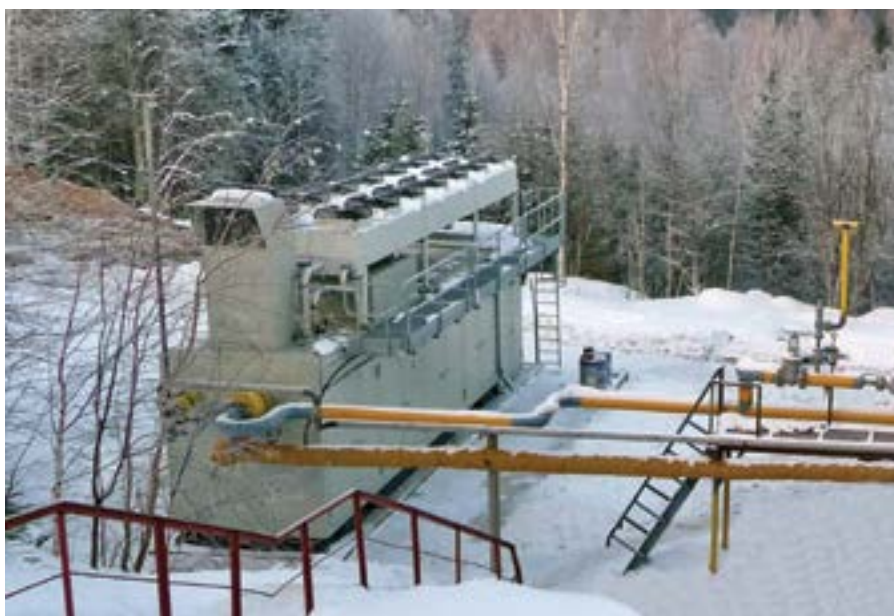
Фото 5. Дожимная компрессорная станция «ЭНЕРГАЗ» для стенда «Протон-ПМ»
