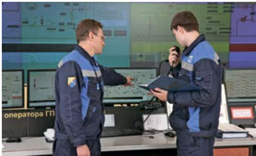
Рис. 8. Единый пульт оператора газового промысла
