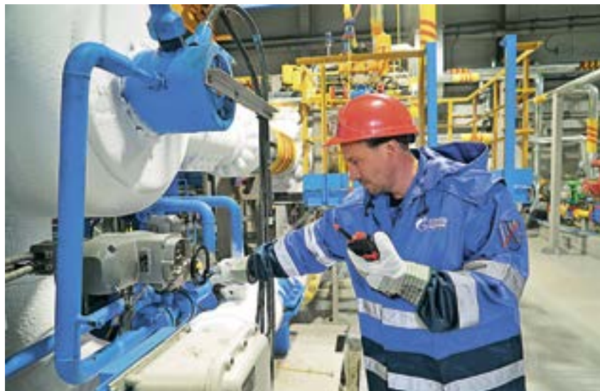
Рис. 6. Установка низкотемпературной сепарации
