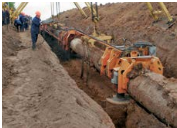
Рис. 1. Ремонт с подкопом под трубопровод Fig. 1. Repair with undermining under the pipeline
