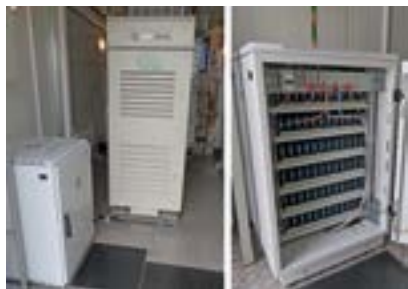
Рис. 6. Суперконденсаторный накопитель гибридной буферной батареи
