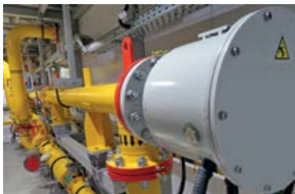
Фото 6. Электрический подогреватель газа в составе газорегуляторного пункта
