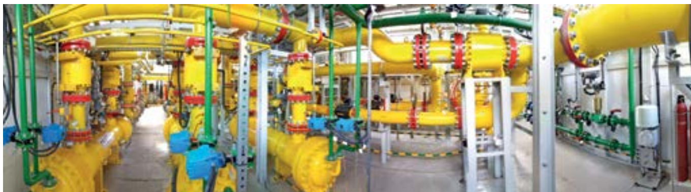
Фото 2. Технологические отсеки многоблочной установки газоподготовки для Прегольской теплоэлектростанции
