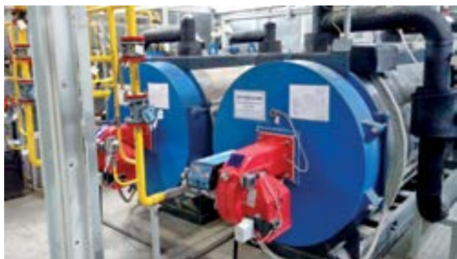
Фото 7. Отсек блочной котельной встроен в общий технологический модуль пункта подготовки газа
