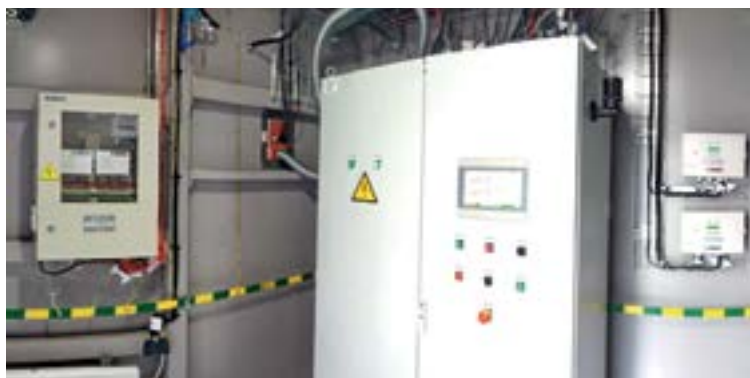
Фото 5. Отсек системы автоматизированного управления комплектной установки подготовки топливного газа для энергоцентра Барсуковского месторождения
