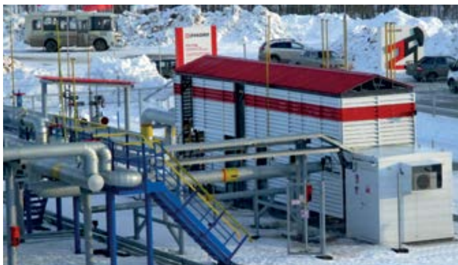
Фото 1. Блок подготовки попутного газа для энергоцентра Усинского месторождения
