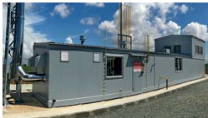
Фото 8. Автоматизированная газораспределительная станция «ЭНЕРГАЗ» с узлом одоризации
