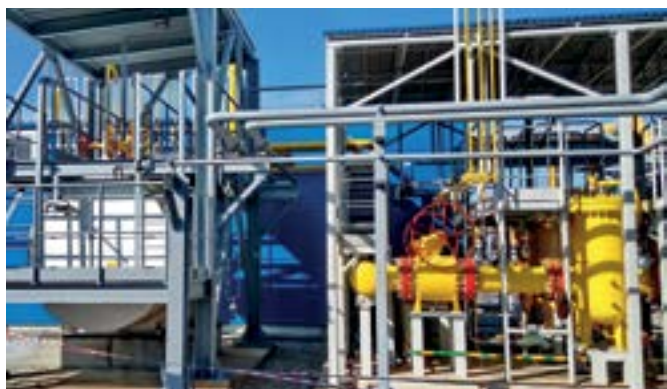
Фото 3. Внешний блок фильтрации и узел дренажа конденсата
