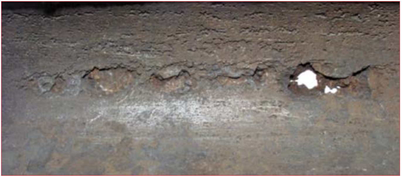
Рис. 1. Общий вид участка трубы с дефектами
