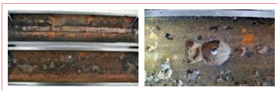
Рис. 3. Углекислотная коррозия НКТ, осложненная продуктами жизнедеятельности бактерий коррозионно-опасного нефтяного биоценоза (Усинское месторождение)
