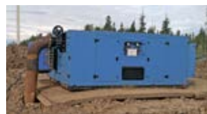
Рис. 3. Вакуумная установка второго поколения в работе Fig. 3. Second-generation vacuum unit in use
