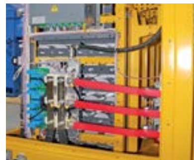
Фото 3. Силовой преобразователь системы возбуждения тягового генератора
