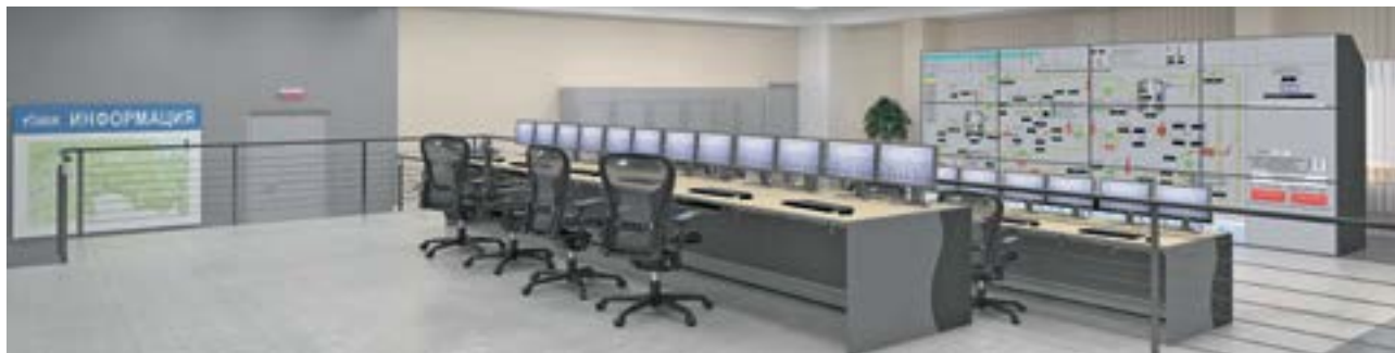
Рис. 3. Единый пульт управления объектами Чаюдинского НГКМ
