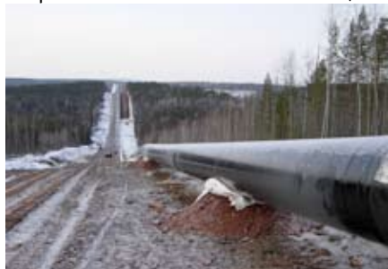
Рис. 1. Магистральный нефтепровод «Восточная Сибирь – Тихий океан»
