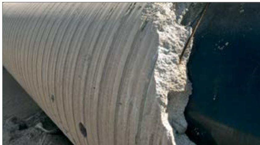
Рис. 5. ОТ с оголенной арматурой после года эксплуатации (металлополимерная оболочка демонтирована)
