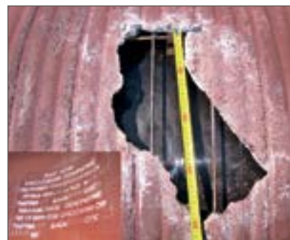
Рис. 2. Воздушный карман в бетонном покрытии ОТ с наружным диаметром 1219 мм
