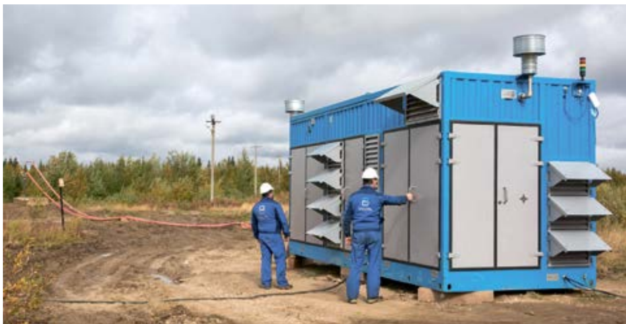
Температура точки росы, измеренная непосредственно внутри трубопровода, составила –41 °С и оказалась значительно лучше требований нормативной документации ПАО «Газпром»
