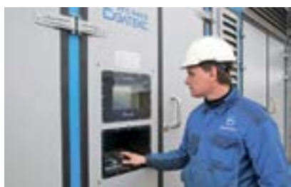
Испытания АГС-940.0 на участке 505–544 км МГ Пунга – Вуктыл – Ухта II (3-я нитка) DN 1400 Сосногорского ЛПУМГ ООО «Газпром трансгаз Ухта»
