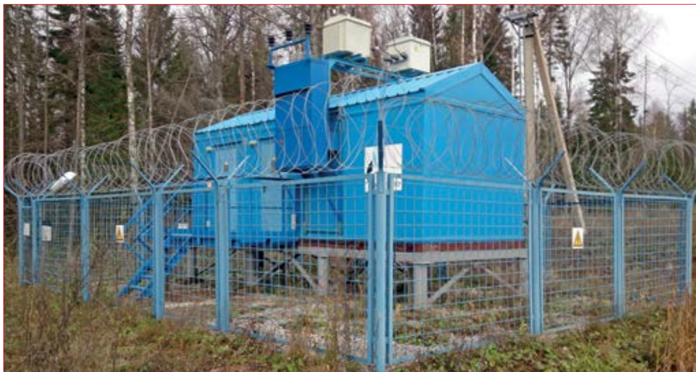
Рис. 2. Блок-бокс ЭХЗ, установленный в ходе реконструкции
