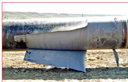
Рис. 3. Пример отслаивания трехслойной ПЭ-изоляции в эксплуатации
