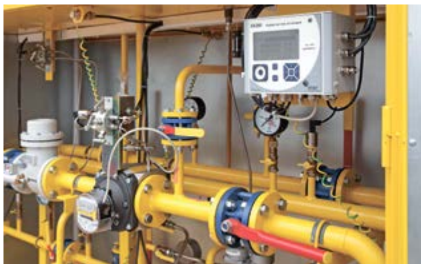
Рис. 1. Шкафной пункт учета и редуцирования газа на базе счетчика газа RABO с корректором ЕК280
