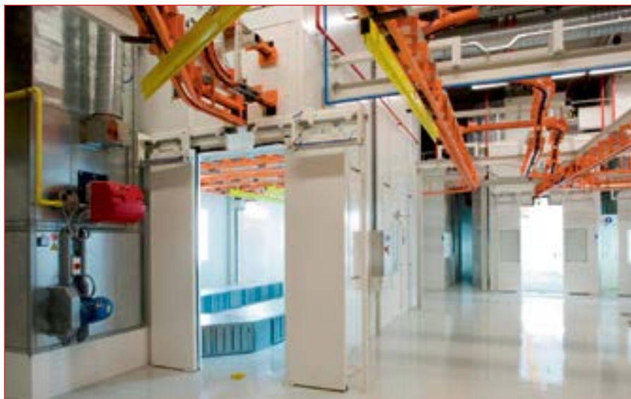
Рис. 5. Окрасочная линия на базе системы Power & Free
