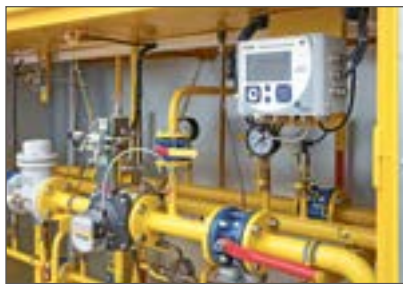
Рис. 2. Вариант применения корректора EK280 в составе пункта учета и редуцирования газа
