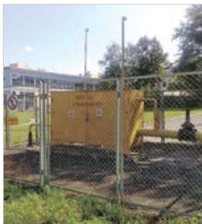
Фото 2. Прежний ПРГ в шкафом исполнении
