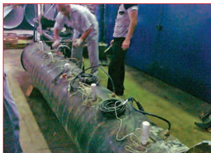
Рис. 5. Установка электродов сравнения, датчиков линейного сопротивления и индикаторов коррозионных процессов в образец и их заливка бетоном
