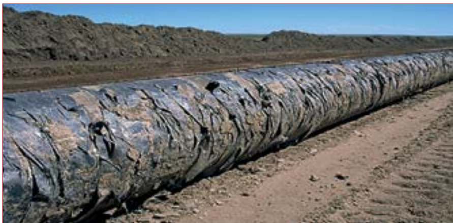
Рис. 1. Состояние полимерной липкой ленты после 10 лет эксплуатации
