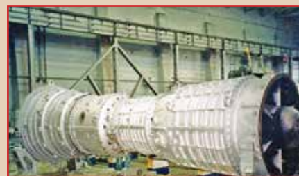
Фото 3. Эмаль антикоррозионная термостойкая «Церта®». Ремонт газотурбинных двигателей предприятий ОАО «Газпром» на ДП «Турбокрон» ФГУП «КМОЛЗ» МО РФ
