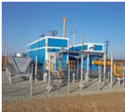
Рис. 2. Компрессорная установка для сбора газа на Вынгапуровском месторождении (МКУ-5). Заказчик – ОАО «Газпром добыча Ноябрьск»
