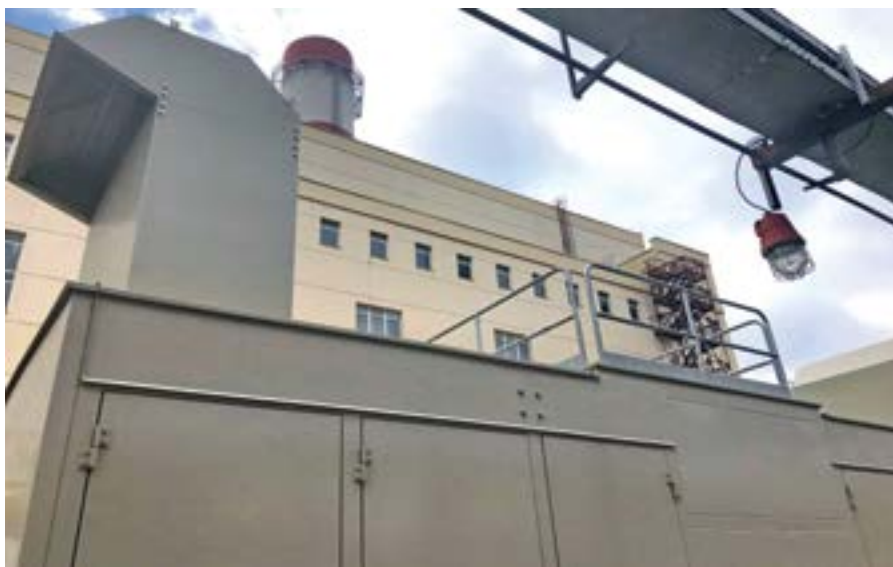
Фото 2. Новая дожимная компрессорная станция топливного газа от компании «ЭНЕРГАЗ»
