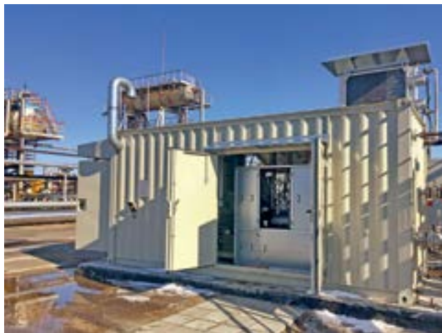
Фото 2. Малая КУ в контейнерном исполнении
