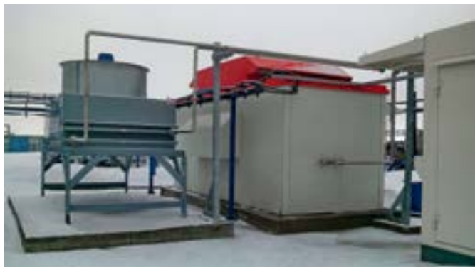
Фото 3. Рефрижераторный осушитель попутного нефтяного газа на Западно-Могутлорском месторождении (ПАО «НК «РуссНефть»)
