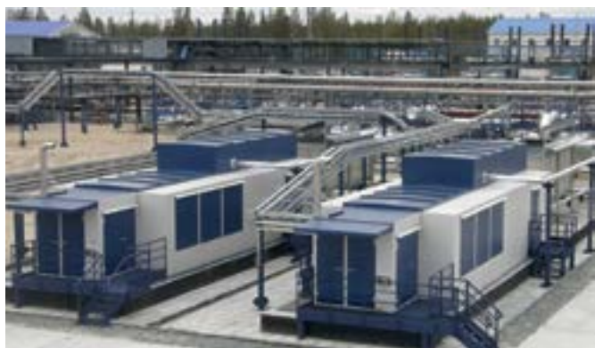
Фото 1. Вакуумные компрессорные установки, спроектированные для низконапорного попутного нефтяного газа (0,001 МПа)
