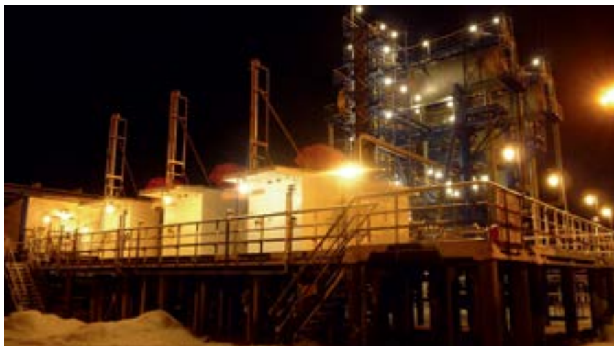
Фото 7. Компрессорная станция низкого давления «ЭНЕРГАЗ» надежно работает в условиях Заполярья (Варандейское месторождение в Ненецком АО)
