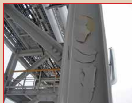
Рис. 2. Разрушение акрилового огнезащитного покрытия под воздействием низких температур – через 4 месяца после нанесения. Эстакады химзавода, Ямало-Ненецкий автономный округ
