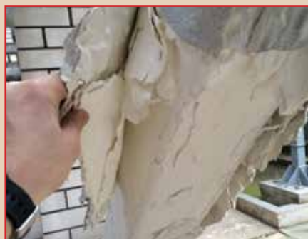
Рис. 1. Разрушение акрилового огнезащитного покрытия от сочетания воздействия сернистых газов и климатических воздействий через год после нанесения. Установка серы, НПЗ, Нижегородская область
