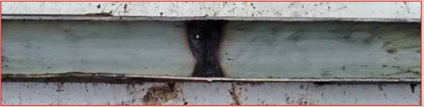
Рис. 2. Сквозная внутренняя коррозия в околошовной зоне трубы с полимерным внутренним покрытием
