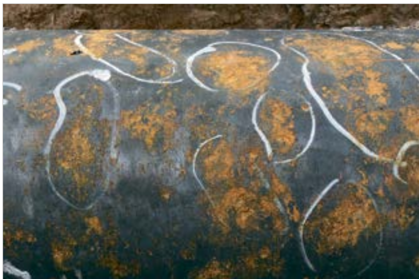
Рис. 1. Процесс коррозии на поверхности трубы
