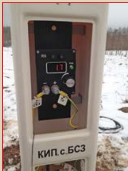
Рис. 2. БСЗ.СК, установленный в контрольно-измерительный пункт
