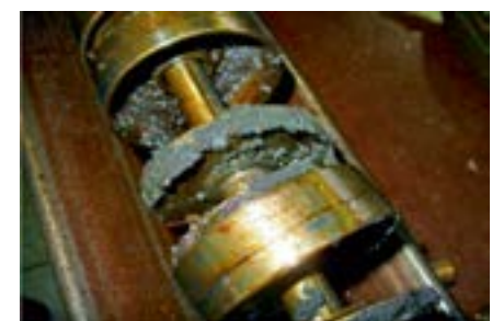
Рис. 3. Засорение проточной части насоса механическими примесями Fig. 3. Clogging the flow channel of the pump with mechanical impurities
