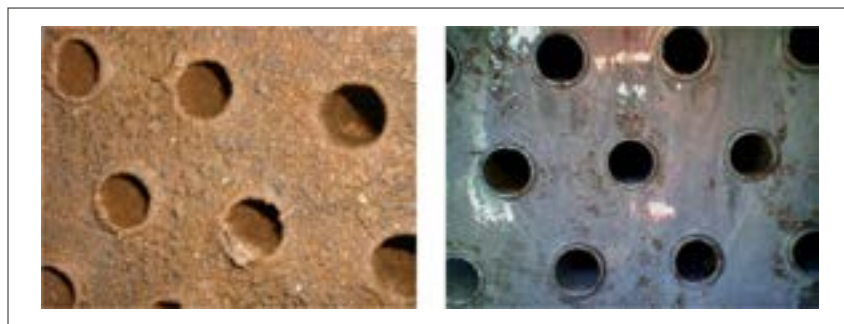
Рис. 5. Трубный пучок АВОг до и после промывки раствором НТ–310
