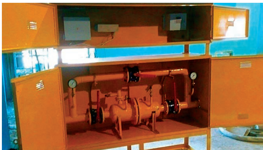
Фото 2. Турбодетандерная установка электропитания узла учета и телеметрии
