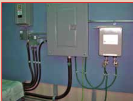
Рис. 1. Установка заменителя поляризационной ячейки в цепи защитного заземления
